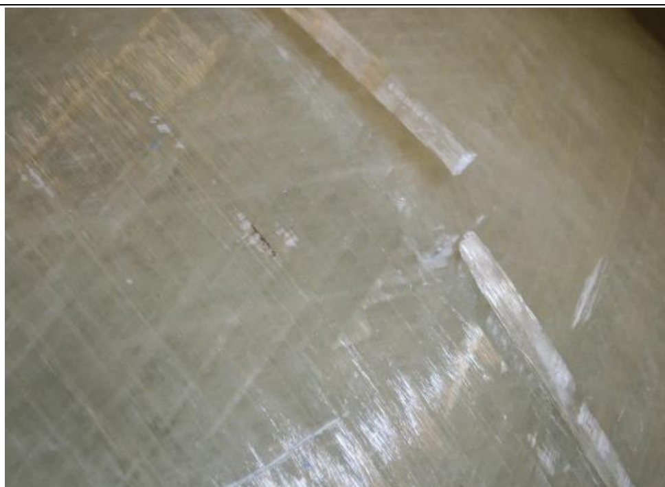
Sono visibili fasciature aperte o staccate
